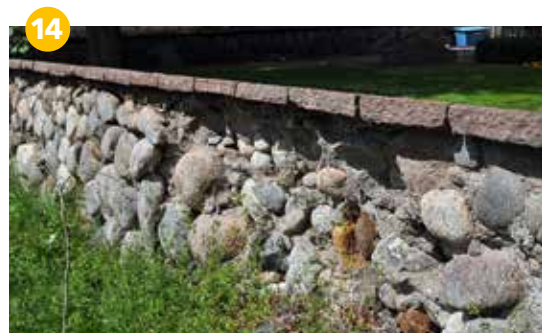
Fältstensmur med betongkärna som har frusit sönder på grund av otät avtäckning.
