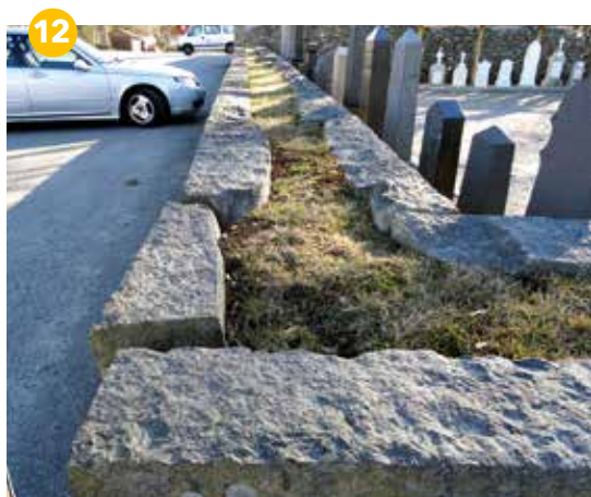
Skalmur som är på väg att "kalva" eftersom den saknar bindare.
