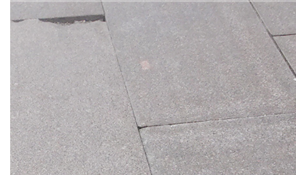
Figur 5 Kantskador på grund av att fogen är 0 mm.
