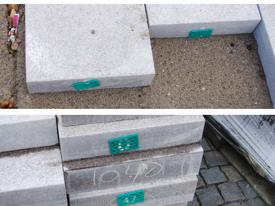
Figur 7 Plastdistanser (övre bilden). Borde ha funnits även på långsidan. Figur 8 (nedre bilden) Distanser pålimmade vid leverans.
