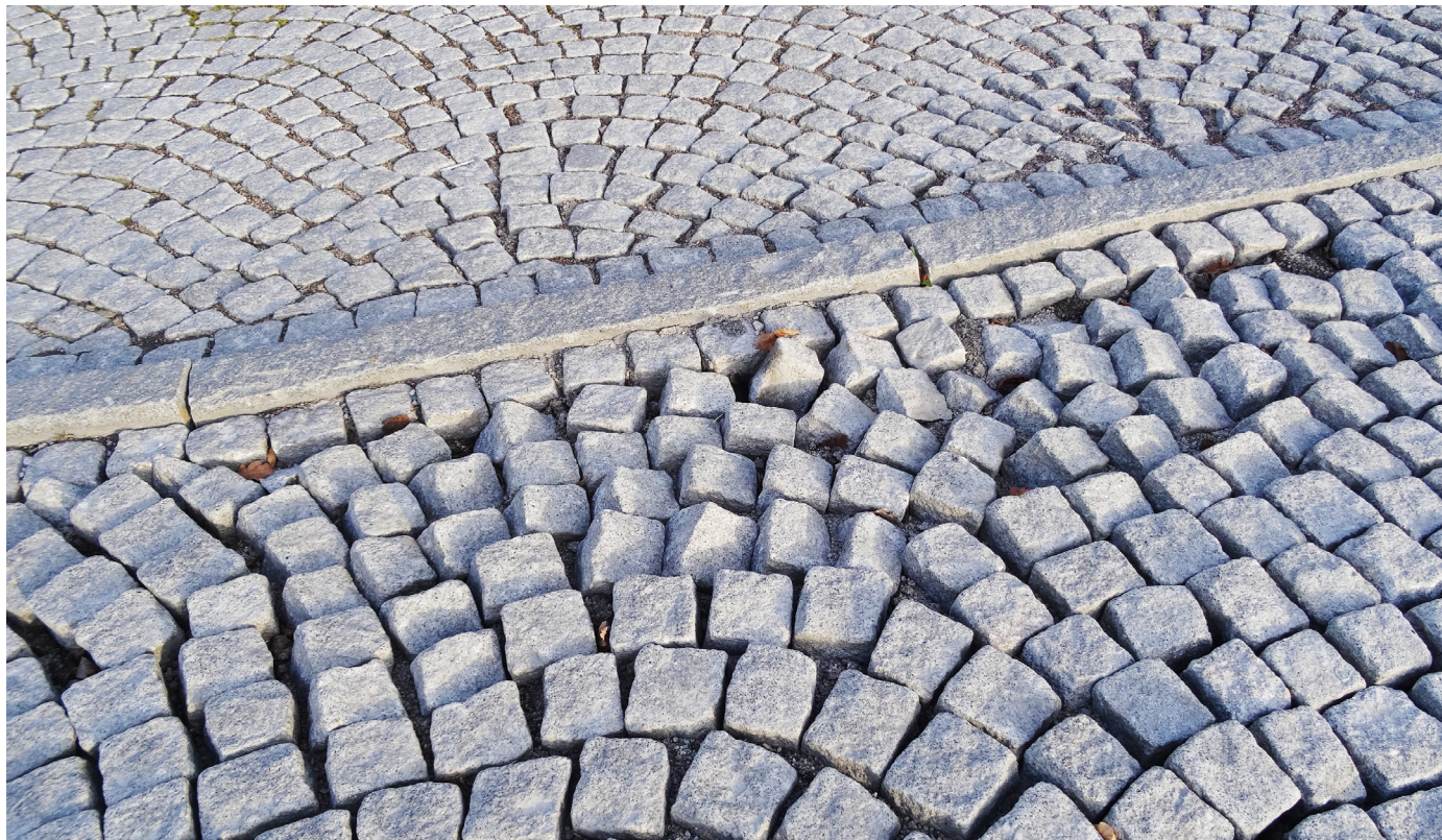
Figur 1 Ibland uppstår helt onödiga problem vid läggning av gatsten. Här är till exempel fogen borta och gatstenarna ligger helt lösa.
