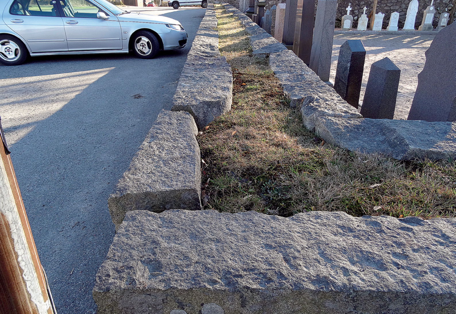
1. Skalmur som är på väg att "kalva", eftersom bindare saknas och fyllningen ej är dränerande
