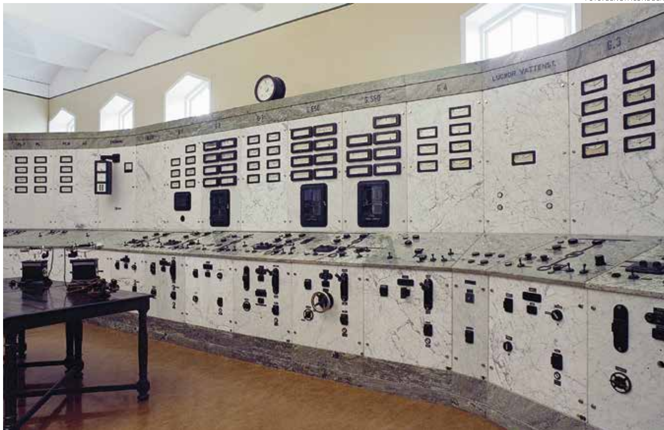
▲ Kontrollrummet i Porjus kraftstation i Lappland. Hela kontrollpanelen är klädd i marmor, bland annat från Kolmården, för att isolera strömförande delar.
