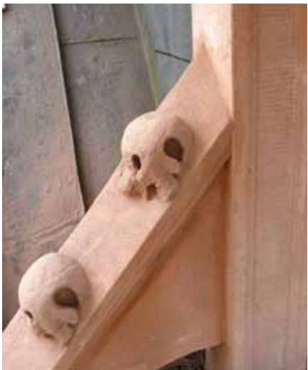
De väderutsatta konsolerna till frontespisen valdes 1898 med en tätare och mindre vittringsbenägen sandsten. Ett klokt beslut, de kunde behållas efter en rengöring. Foto Mats Edström
