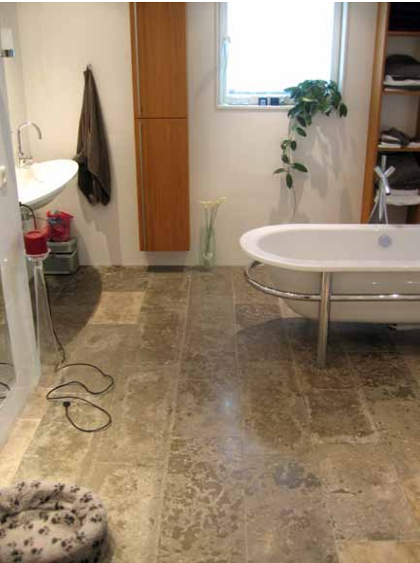
Våtrum har hög vattenbelastning som kan ge skador på kalkstengolv
