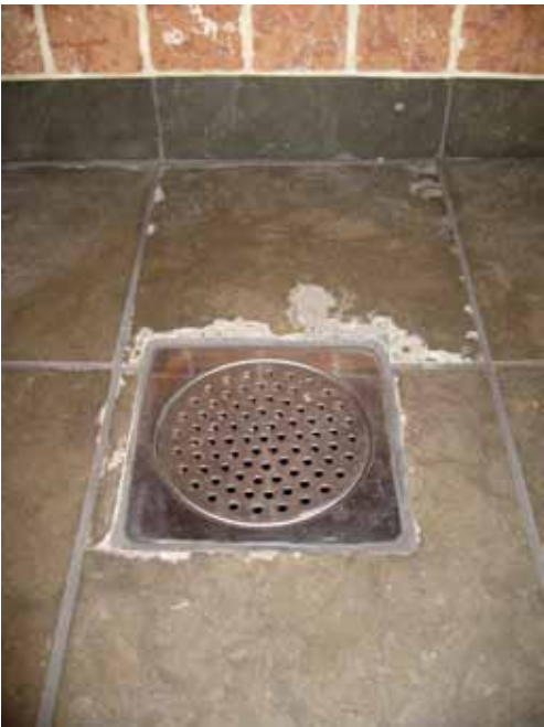
Kraftiga skador på kalkstengolv i dusch
