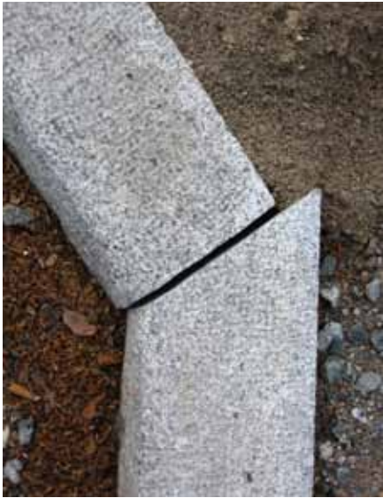
Ej fackmässigt utförda kapningar/sammanfogningar av kantstenar.
