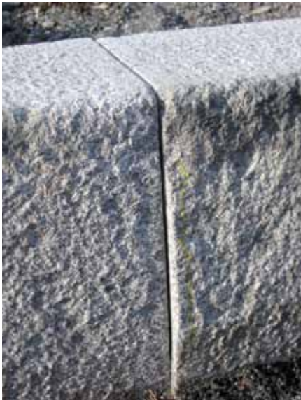
Bristande toleranser i den fasade ytans vinkel och planhet orsakade stora fogsprång.
