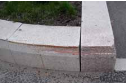
Ibland var det lätt att konstatera att entreprenören inte hade orsakat skadorna.
