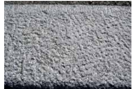
Krysshamring på sågade ytor var bitvis bristfällig med släta sågytor mellan krysshamringens fördjupningar.
