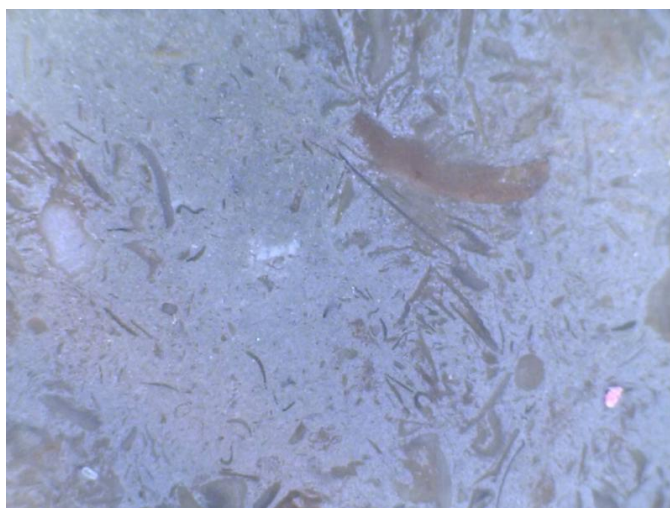
Bild 5: Saltutfällningar som är avtorkningsbara ger bedömningen 1.
