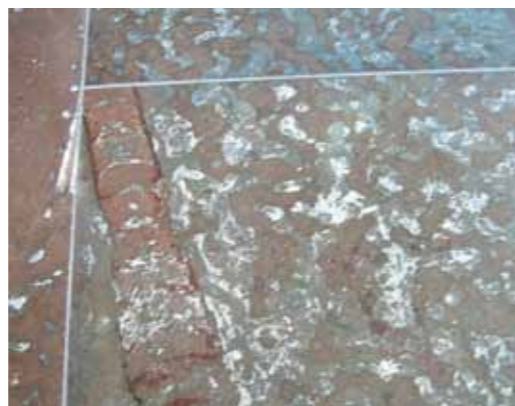
Fig 3.29 Saltvittring i kalkstensgolv.
