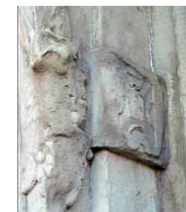
Fig 3.22 Sandnings- och exfolieringsskador Gotlandssandsten(karbonatbunden). Petersenska huset, Munkbron, Stockholm.
