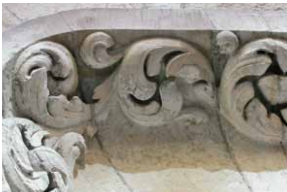
Fig 4.13 Lagning med rekonstruktion av skadat bladverk och listkant. Portal i kalksten, Vidargatan, Stockholm. Foto taget ca tio år efter utförandet.
