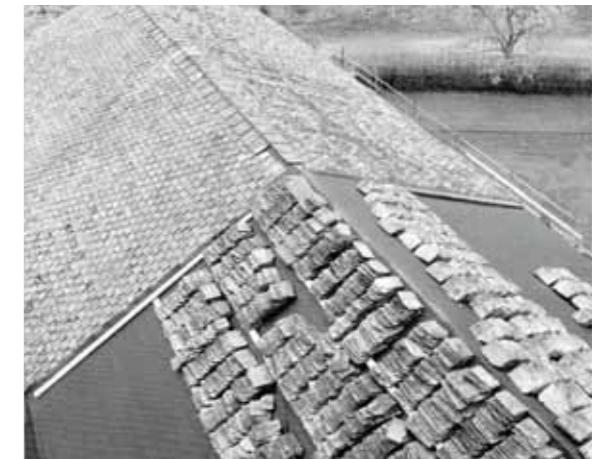
Fig 5.7 Omläggning av skiffertak på Frykeruds kyrka i Värmland 1993. Skifferraderna linjeras upp med snören. Skiffern spikas i hak.
