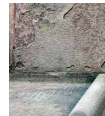
Fig 3.21 Exfolieringsskador, Roslagssandsten (kvartsitbunden). Storkyrkan, Stockholm.
