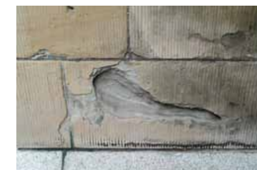
Fig 3.20 Exfolieringsskador, Gotlandssandsten(karbonatbunden). Tyska kyrkan, Stockholm
