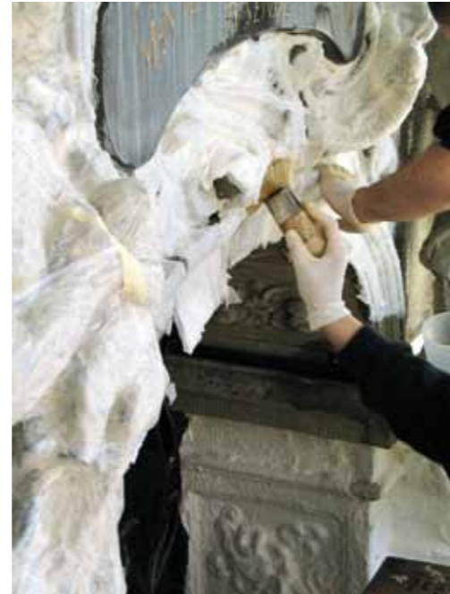
Fig 4.8 Avsaltning. Cellstoff appliceras på stenen. Petersenska huset, Munkbron, Stockholm
