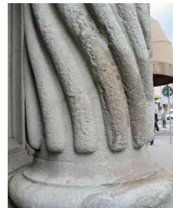
Fig 3.35 Alltför hård blästring har orsakat skador.
